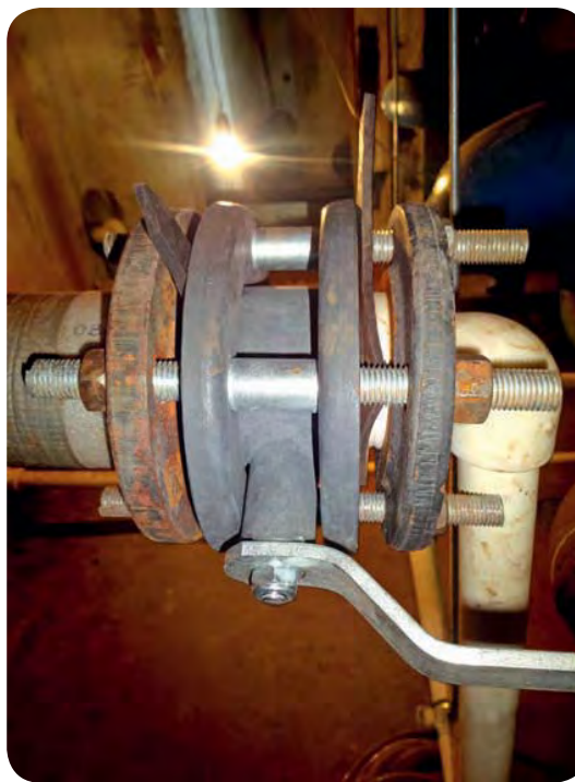
ПОДВАЛ ЖИЛОГО ДОМА (КОНТУР ГВС)
